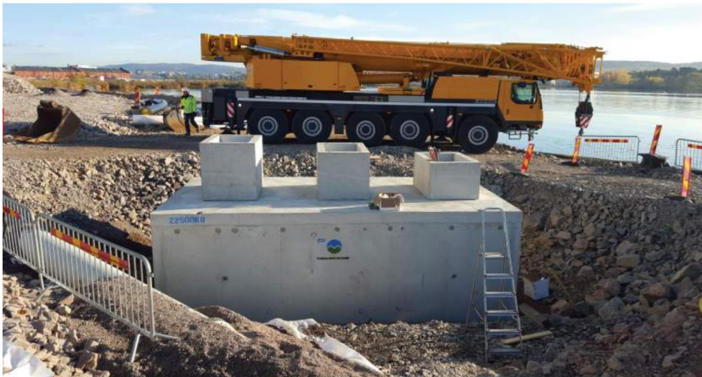
Figur 8 Dagvattenmagasin med filter anlagt i utfyllnadsområde.
